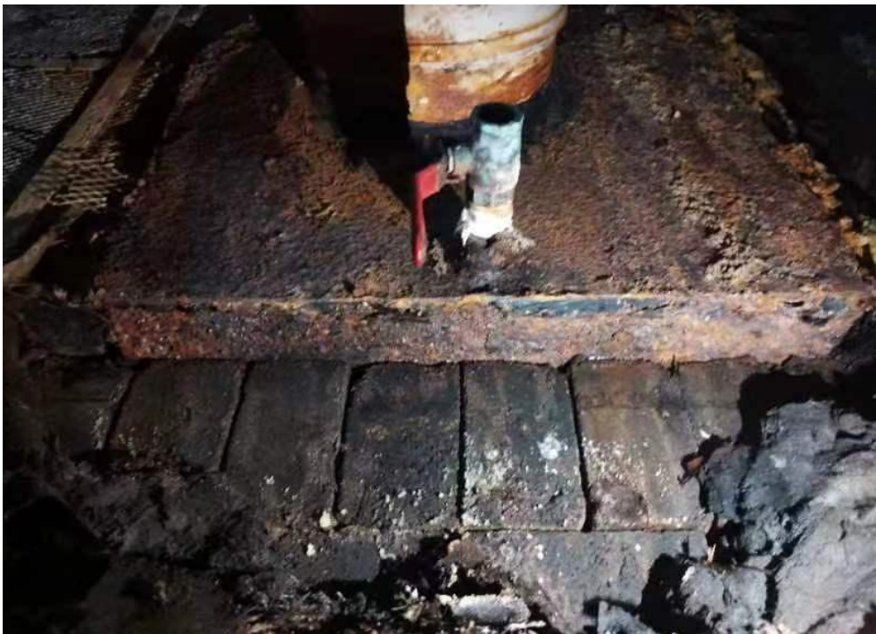
图 3 墙体与风道盖板密封处破损情况
