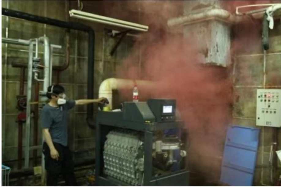
图5 金属板与墙体烟道贴合处存在缝隙
