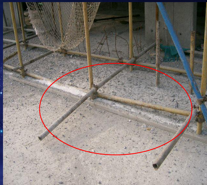
纵向扫地杆严重变形
